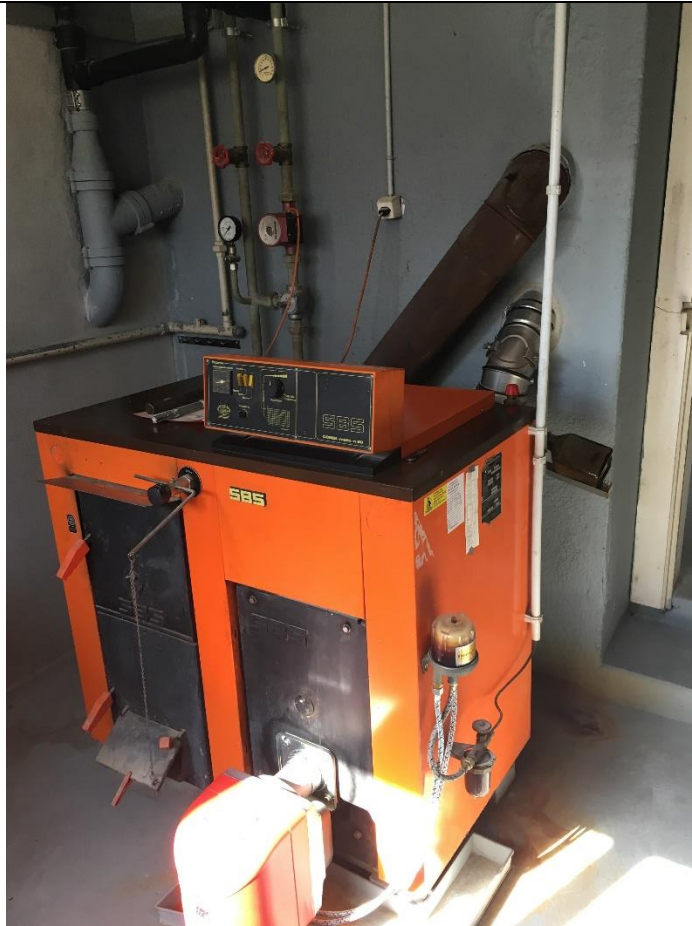
UG: Heizung /Wasch- küche
